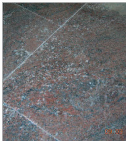
2.7 ábra – Az aljzattól felszivárgó nedvesség okozta kivirágzás
