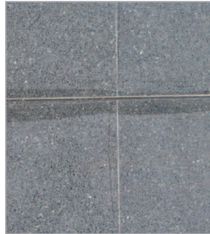
4.10 ábra – Ecetsavasan térhálósodó szilikonos szigetelőanyag által okozott foltosodás természetes kőn
